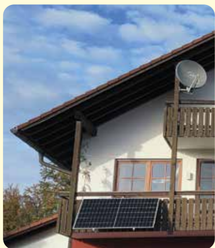
Mit einer hauseigenen Photovoltaik-Anlage lässt sich Solarstrom für den Eigenbedarf produzieren. Fotoquelle: Stadt Geretsried
