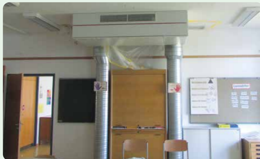
Die neuen Lüftungsanlagen an der Isardammsschule sind teilweise schon verbaut, gewisse Teile fehlen aber noch. Fotoquelle: Stadt Geretsried
