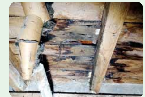
Nasse Decke: Das Dach des Rathauses war zuletzt bereits an etlichen Stellen undicht. Fotoquelle: Stadt Geretsried
